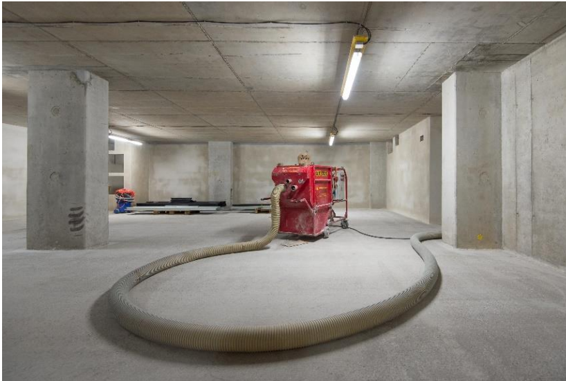
03 Kompressor einer Kugelstrahl- anlage zur Vorbereitung des Rohbetons für den Estrich, Juni 2020, Foto: GNM/Florian Kutzer
